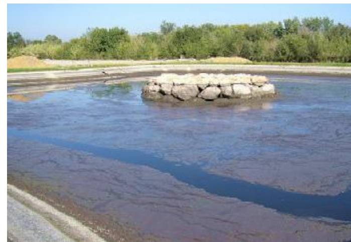
Arrastre de fangos a la laguna de sedimentación de la EDAR de Empuriabrava, mucho más fácil de vaciar y limpiar que el sistema de humedales.
